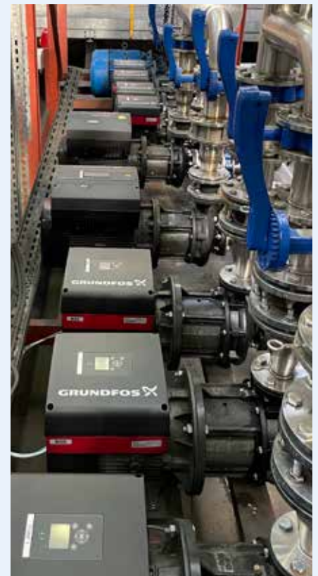
ปั๊ม NBE ของ Grundfos สำหรับระบบน้ำเย็นของ Suntory Beverage & Food
