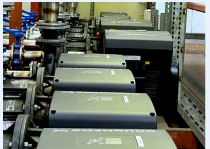
ชุดระบบ NBE ของ Grundfos NBE แบบปั๊มคู่ 14 เซต พร้อมด้วยมอเตอร์ประสิทธิภาพสูง IE5 ขนาด 11 kW ทำงานด้วยการควบคุมแรงดันคงที่สำหรับการใช้งานน้ำเย็นส่วนกลางของ Lucozade
