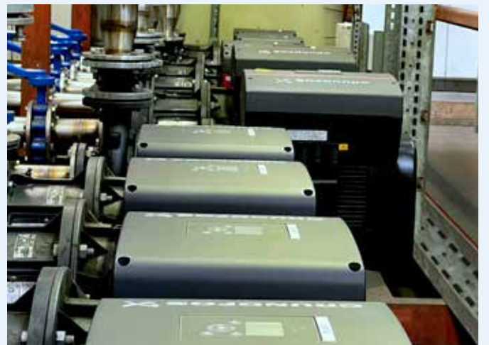
11 kW の高効率 IE5 モータを搭載したGrundfos NBE システム 14 台が、定圧制御に基づいてルコゼードの冷却アプリケーションで稼働しています。
