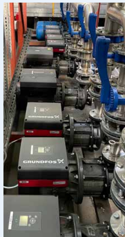
Suntory Beverage & Food GB&I 社の冷水システムで使用されているGrundfos NBEポンプ。
