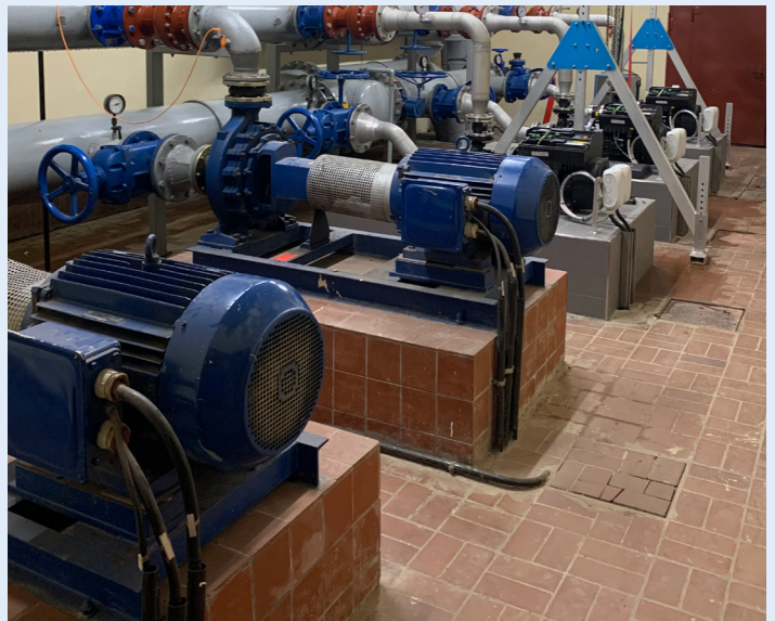
Groupe de surpression en phase de reconstruction - anciennes pompes au premier plan, 3 nouvelles pompes NBE 65-200/198 en arrière plan (juin 2022)
