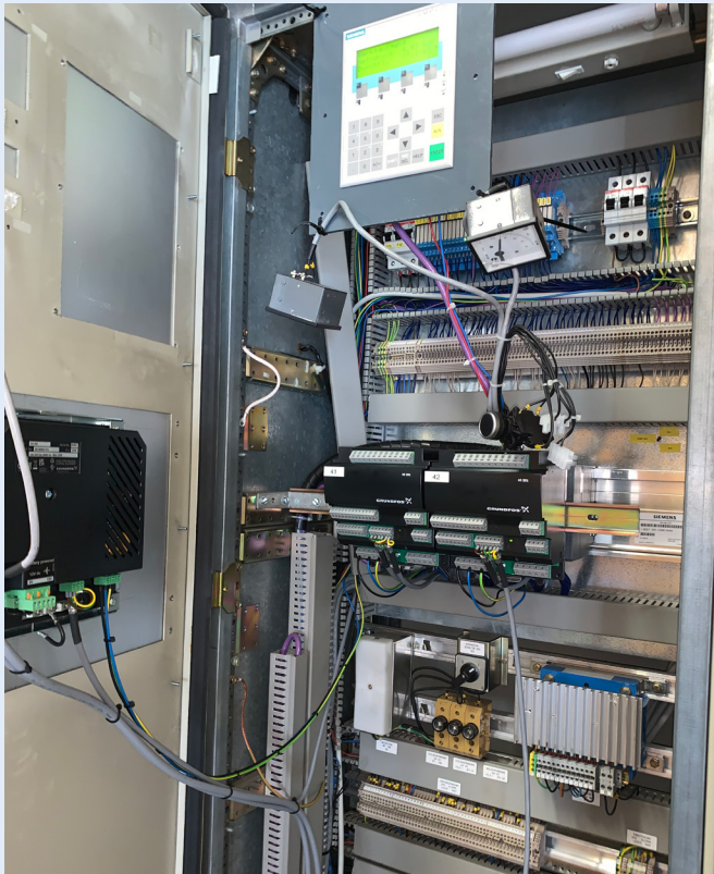
Ancienne technologie de régulation dans l'armoire de commande pendant la phase de conversion
