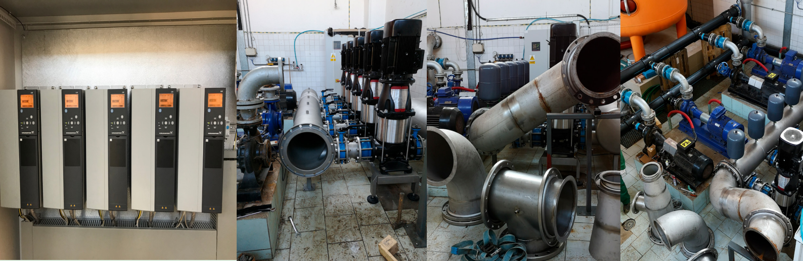
Image : Installation de cinq nouvelles pompes verticales Grundfos CR 125-2-1 très efficaces avec des variateurs de fréquence dédiés (VFDs)
