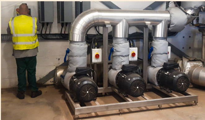
Kylmävesijärjestelmän uudet NB-pumput
