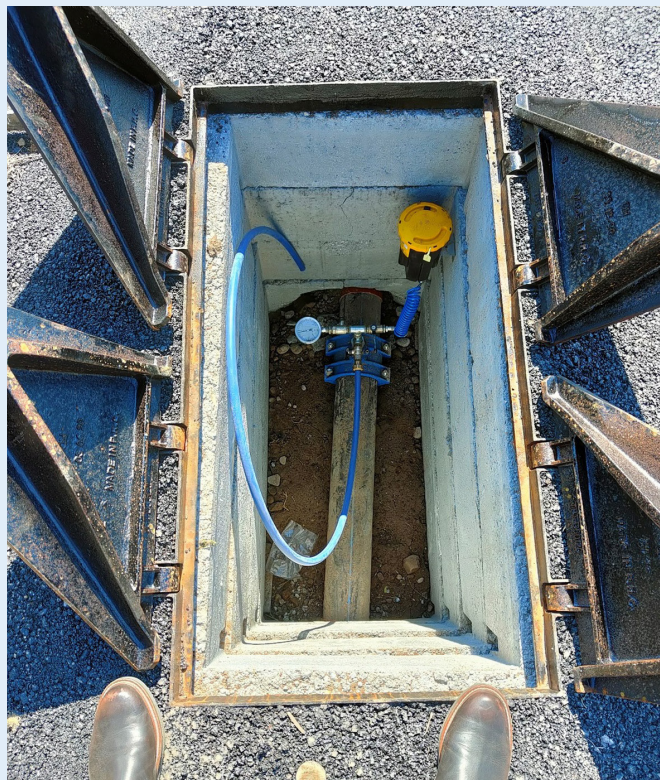
Arqueta de registro: Sensor de presión de punto crítico.
