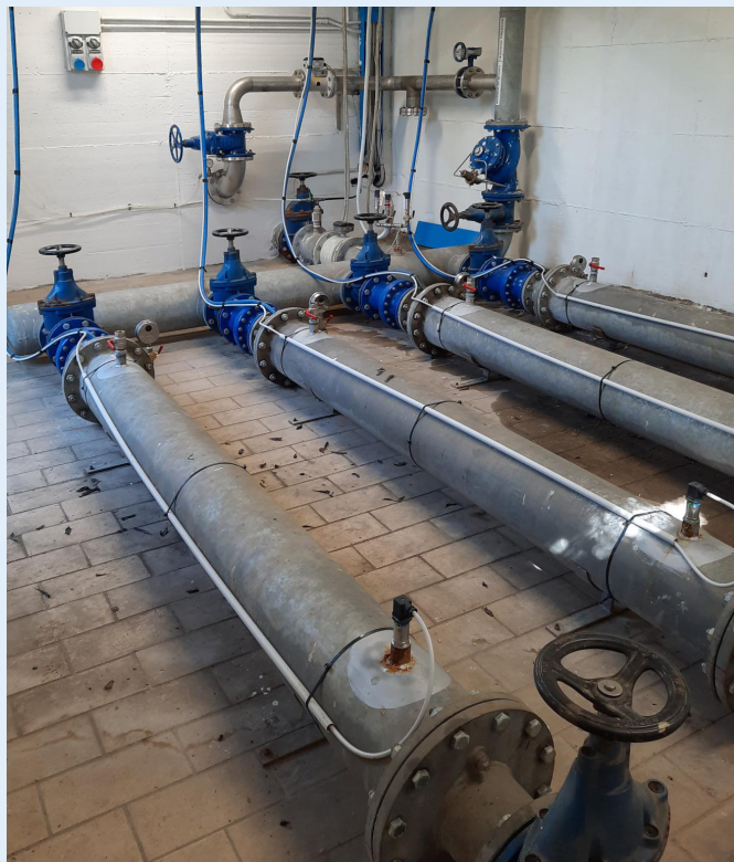
Estación de bombeo.
