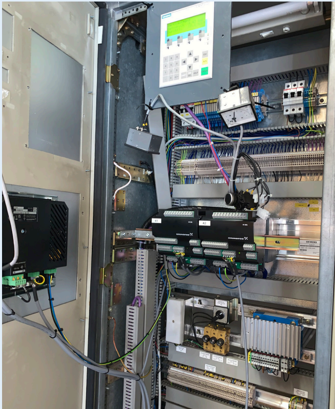
Tecnología de control antigua en el armario de control durante la fase de renovación
