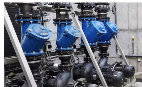
Instalace čerpadel řady Grundfos NB pro čerpání průmyslových odpadních vod.
