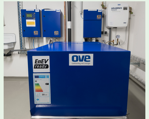
Ana ısı üretici, 21 kW termal ve 9 kW elektrik çıkışına sahip kompakt bir CHP sistemidir.
