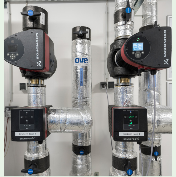
Faz 1 (sağda) ve 2 (solda) için her biri MIXIT kontrol ünitesine ve MAGNA3 ikincil devre pompasına sahip karıştırma devreleri.
