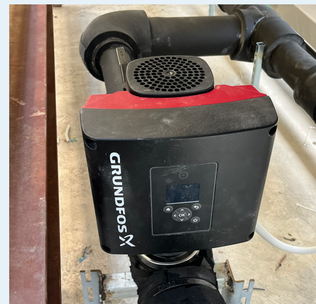
Αντλία in-line σειράς TPE3 στο Δώμα τροφοδοτεί το πρωτεύον κύκλωμα.
