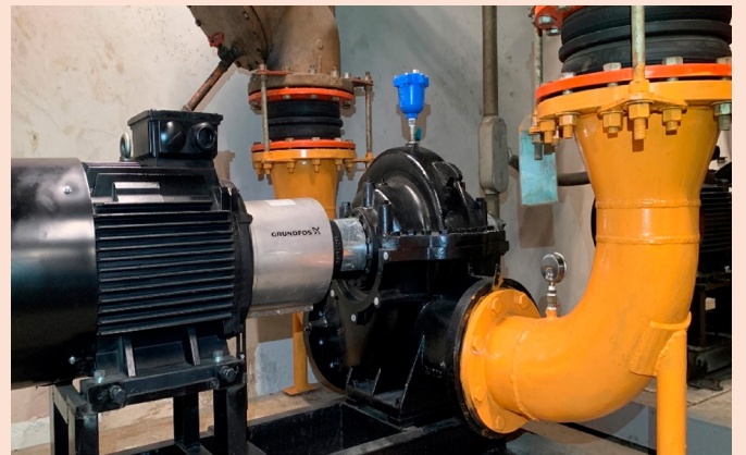
Bomba para manejo de condensados del chiller
