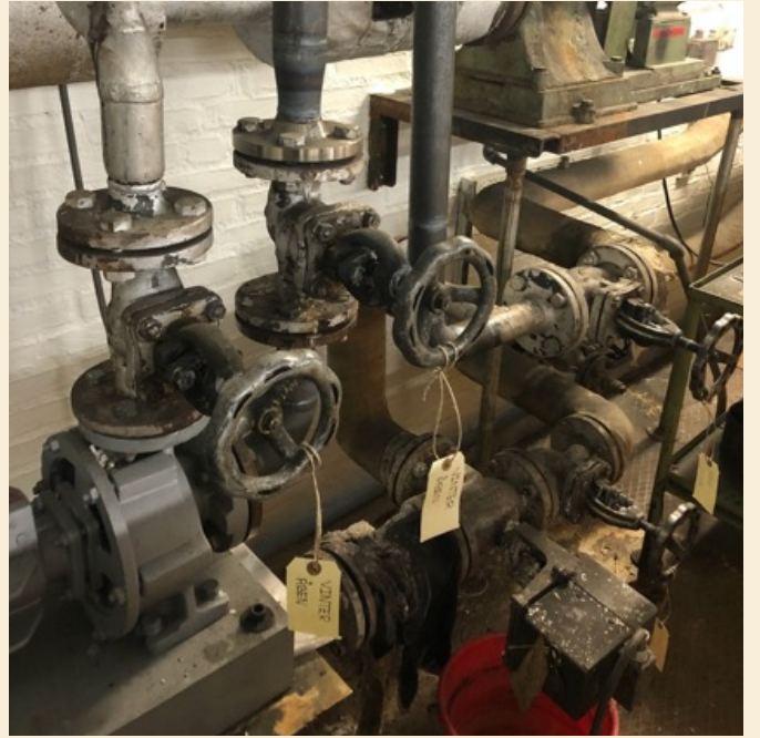
MIXIT uygulamasından önceki Envases karıştırma devresi.
