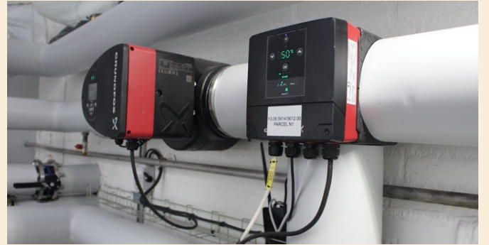
MIXIT uygulamasından sonraki karıştırma devresi. Grundfos MIXIT ünitesi sağda, Grundfos MAGNA3 sirkülasyon pompası solda.
