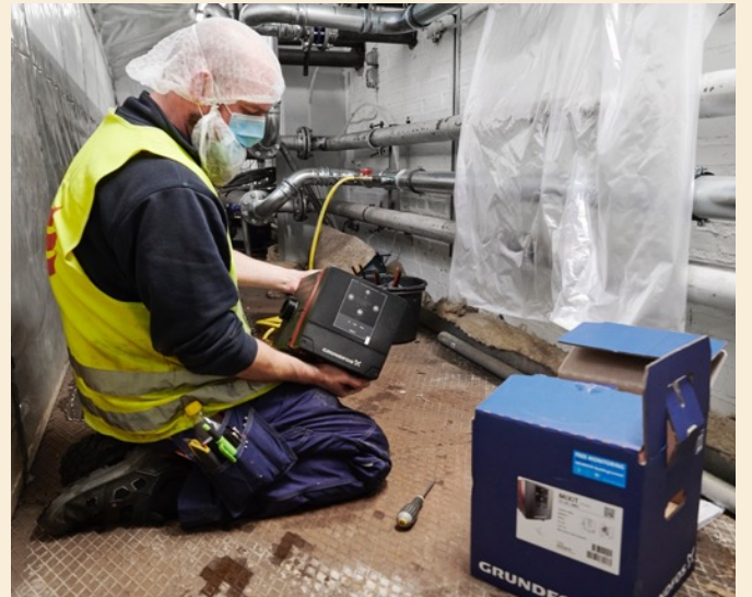
Danimarka'nın Odense kentindeki Envases'te bir Grundfos MIXIT kurulumu.
