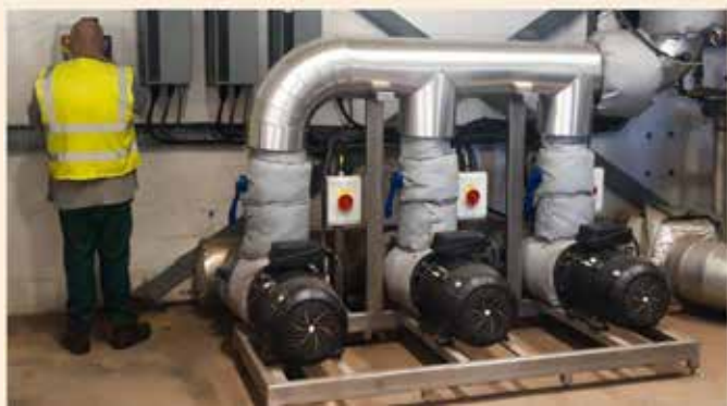
新たな冷水用 NB ポンプ
