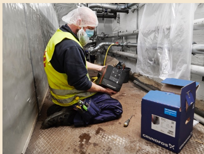
Zdjęcie: Instalacja urządzenia Grundfos MIXIT w firmie Envases w Odense (Dania)
