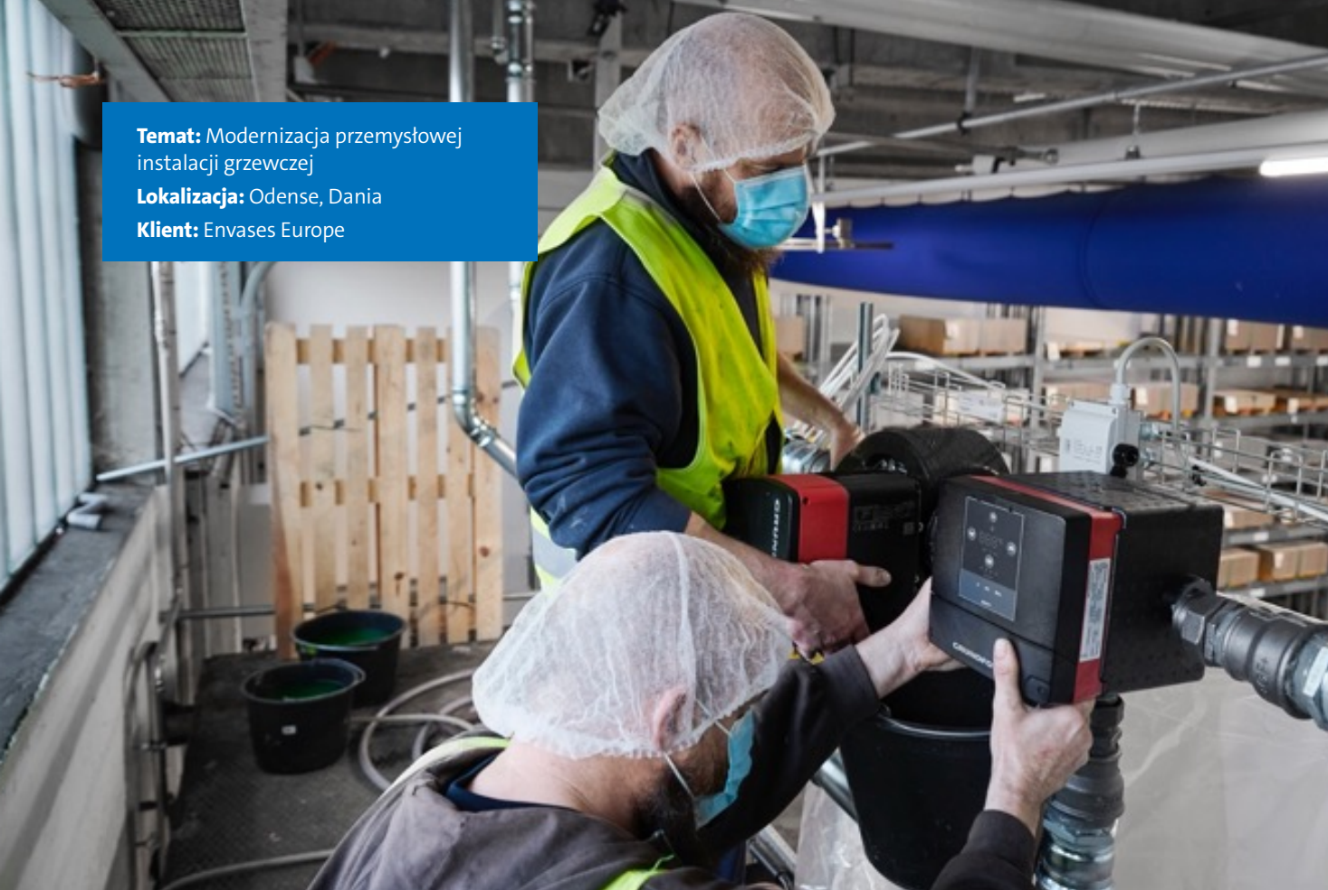
Zdjęcie: Instalacja urządzenia MIXIT przy wykorzystaniu pompy obiegowej MAGNA3 do systemu HVAC Envases.
