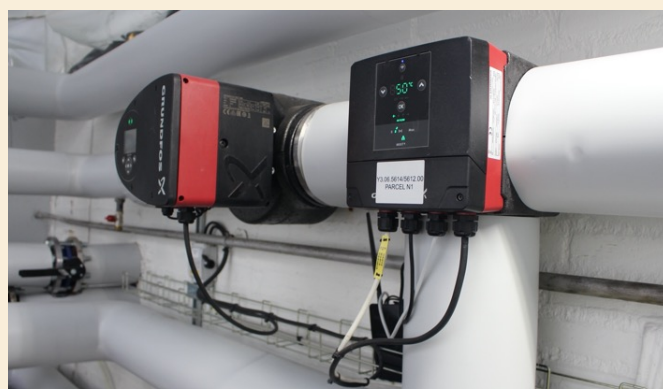
O circuito de mistura após a reconversão para o MIXIT. A unidade Grundfos MIXIT encontra-se à direita e, à esquerda, temos uma bomba de circulação MAGNA3 da Grundfos.
