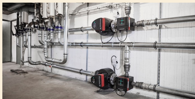
Dois circuitos de mistura recém-instalados com unidades MIXIT e MAGNA3 da Grundfos na Envases.
