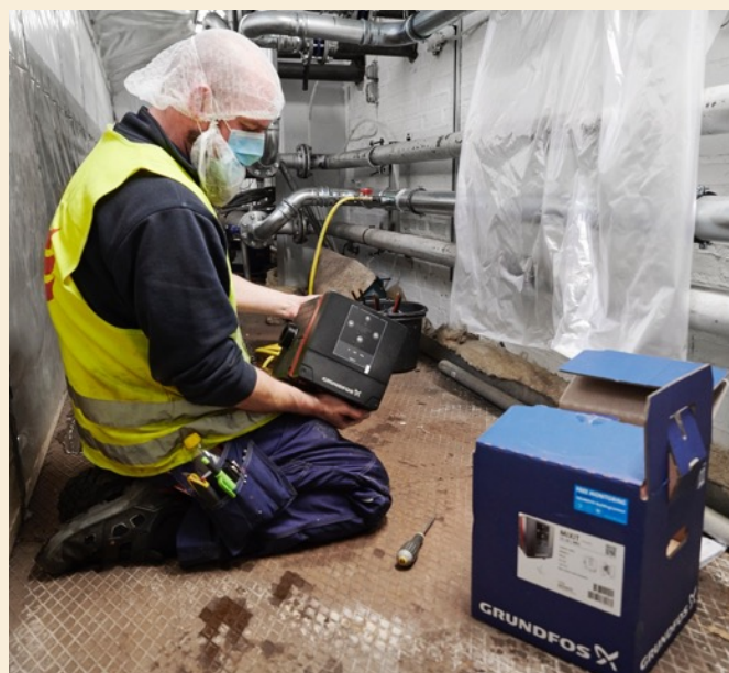
Instalação de um MIXIT da Grundfos na Envases em Odense, na Dinamarca.
