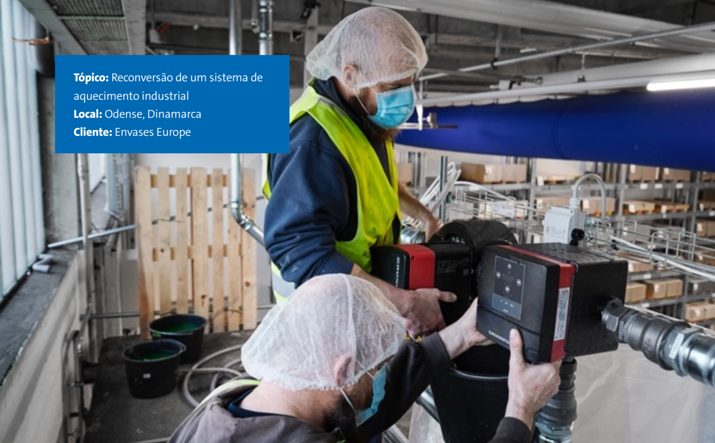
Instalação de uma unidade MIXIT com uma bomba de circulação MAGNA3 para o sistema de AVAC da Envases..
